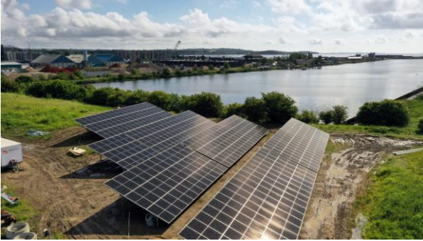
Solcelleanlæg på Horsens Centralrenseanlæg Foto: Samn Forsyning
