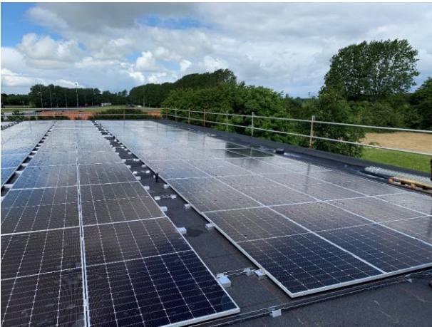
Solceller på taget af Rugballegård Vandværk. Foto: Samn Forsyning
