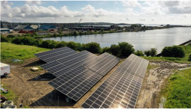
Foto: Solcelleanlæg på Horsens Central Renseanlæg, Samn Forsyning
