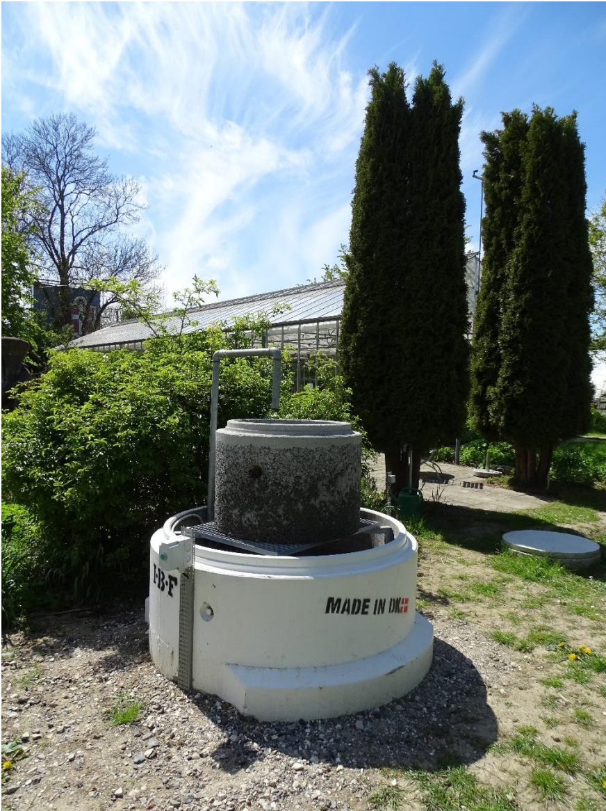
Opsamling af regnvand – permeabel regnvandsbrønd, her anbragt oven på jorden for at demonstrere hvordan vandet kan sive ud i jorden.
